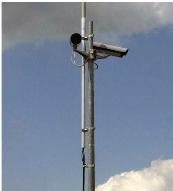
Bild 4 HVI-Leitung, am Mast installiert
